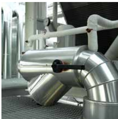
Применение в установках кондиционирования
