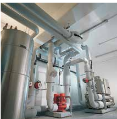
Применение в насосных агрегатах
